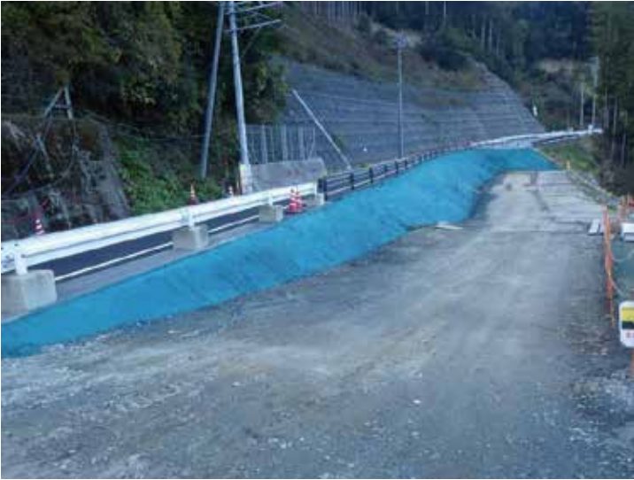
12月の不適期施工
