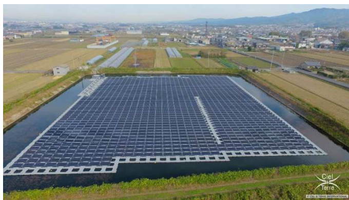
奈良県天理市 1.81MW 「武蔵新池太陽光発電所」 「武蔵古池太陽光発電所」 「檜垣新池水上太陽光発電所」 （水田湖二株式会社様、水上フロート設置）
