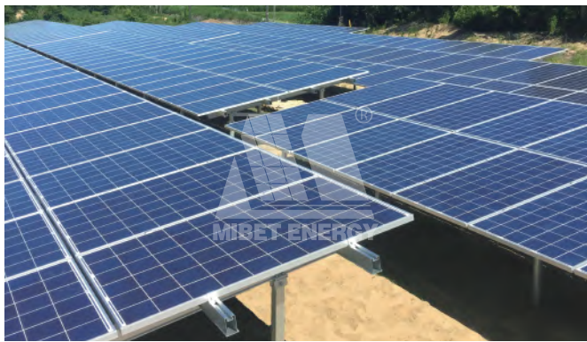
▲ 日本茨城県常陸太田市 1.87MW
