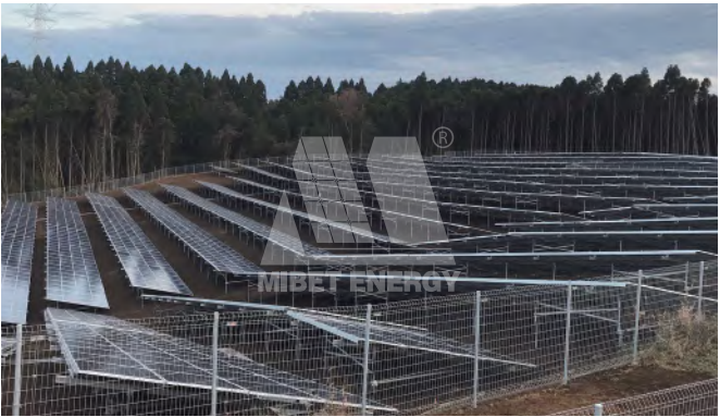
▲ 日本千葉県 5.5MW
