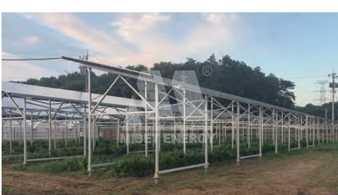
▲ 日本茨城県営農架台
