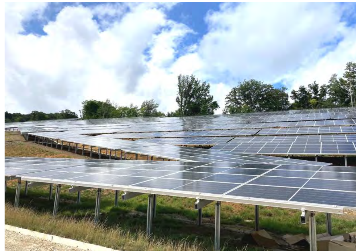
日本石川県 容量:55MW
