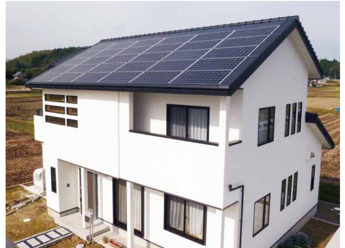
新築 6.00kW 茨城県北茨城市
