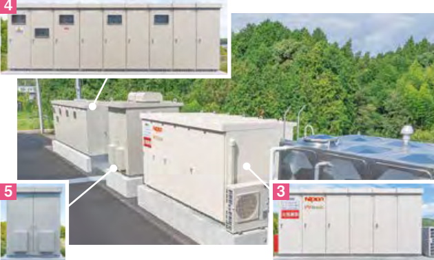
3 工場側 蓄電システム(360kWh) 4 受変電キュービクル 5 パワーコンディショナ / 逆潮流抑止制御装置
