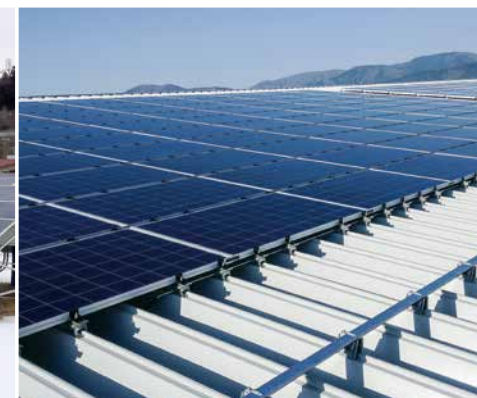
折板屋根 滋賀県長浜市 / 49.92kW
