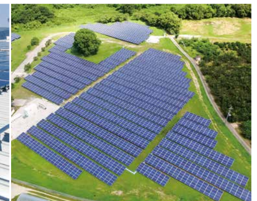
メガソーラー 和歌山県伊都郡 / 1.25MW
