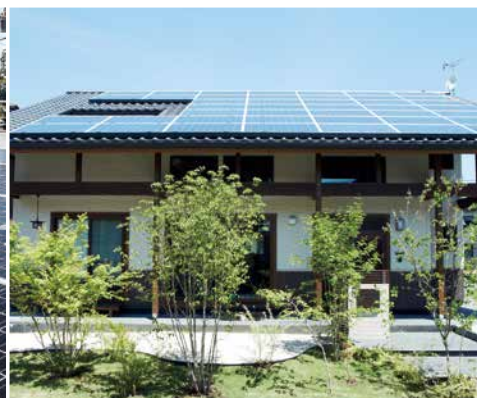
傾斜屋根住宅 栃木県宇都宮市 / 10.32kW
