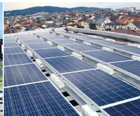
陸屋根住宅 (低圧) 神奈川県南足柄市 / 10.4kW
