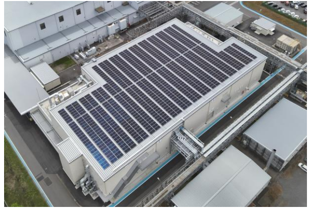
屋根に設置した太陽光発電設備
